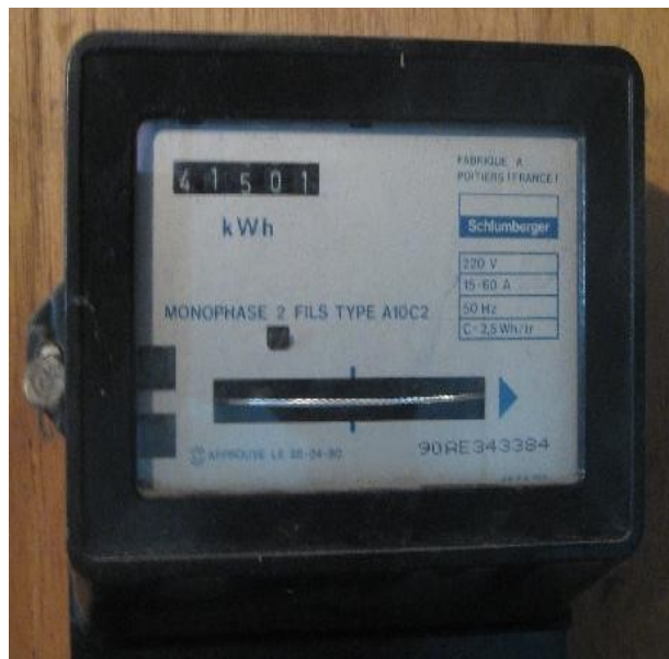
Compteur d'énergie électrique en kWh
